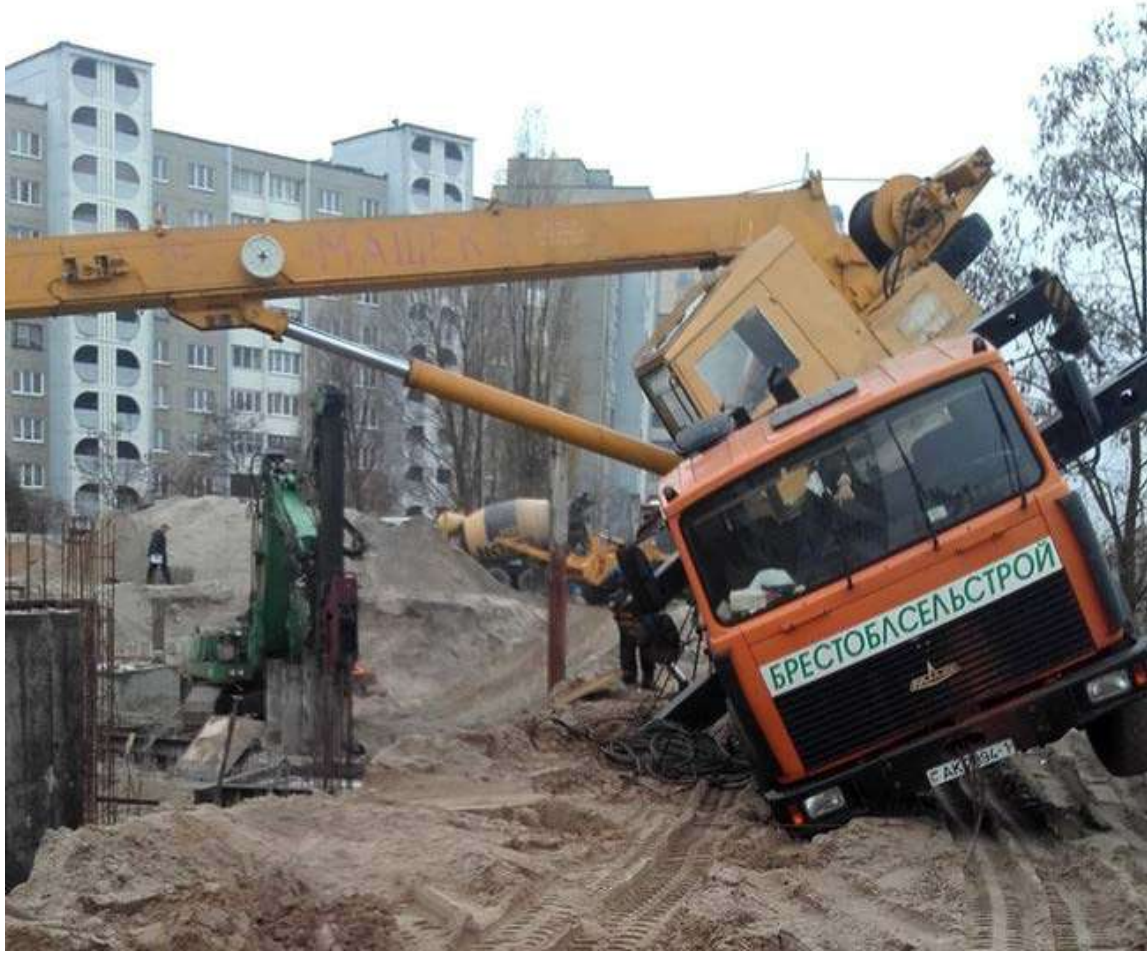
Рисунок 1.6 – Опрокидывание автокрана в результате просадки грунта под аутригером
